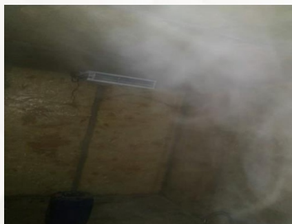
Bagian Dalam Ruang Cold Storage
